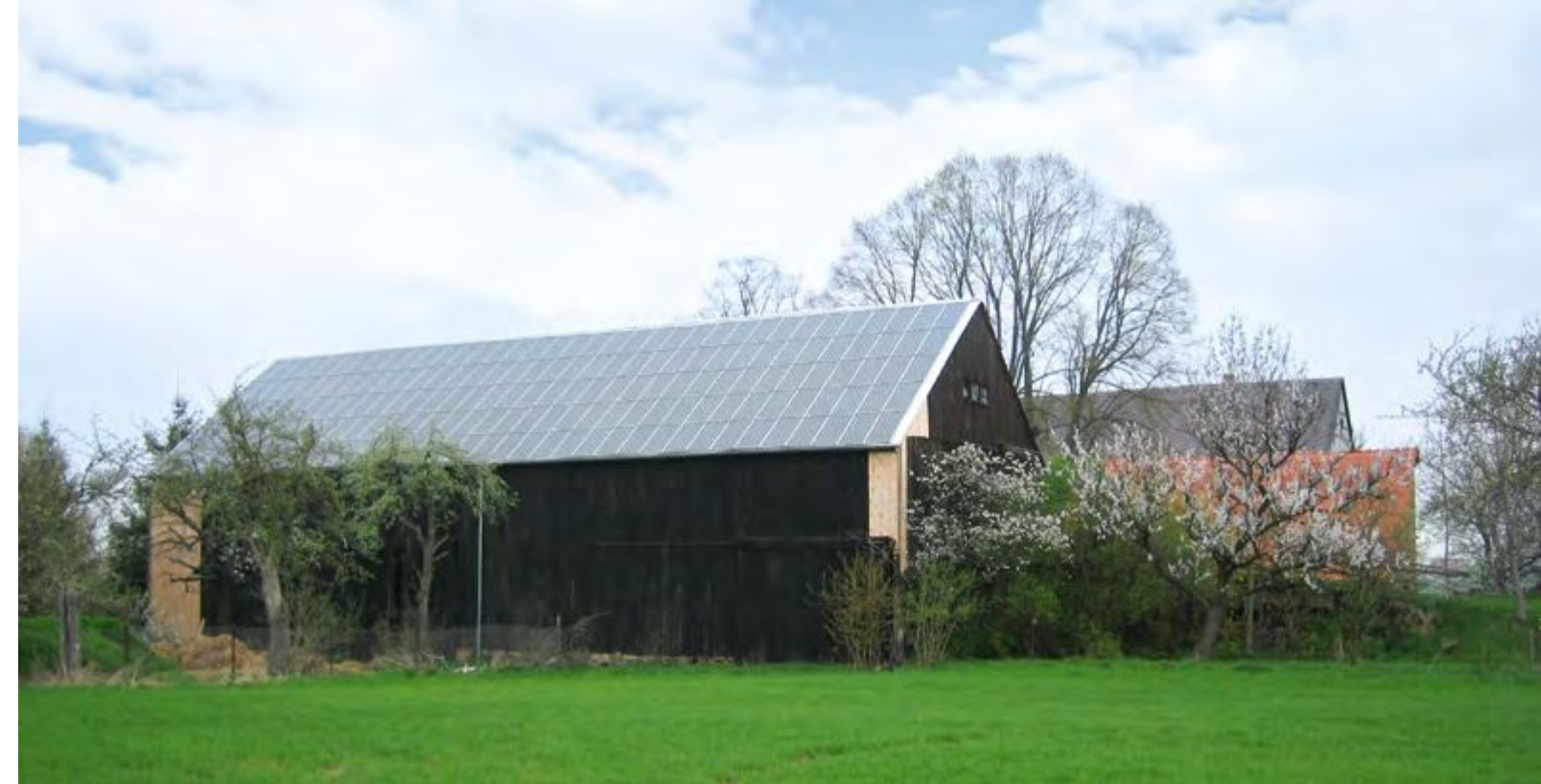
Nutzung der Dachfläche einer ansonsten ungenutzten Scheune zur Erzielung solarer Gewinne
