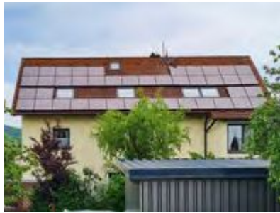
Rote Photovoltaikmodule als Aufdachanlage
