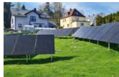
Im Garten errichtete Photovoltaikgeneratoren mit unterschiedlichen Ausrichtungen
