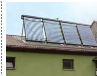
Aufgeständerte Vakuumkollektoren auf einem Nebengebäude
