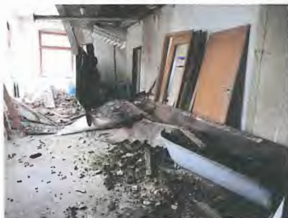
eingestürzter Deckenbereich im Ostteil
