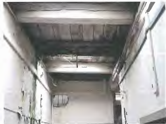
5a, Dachkonstruktion, Nässeschäden, Schwammbefall
