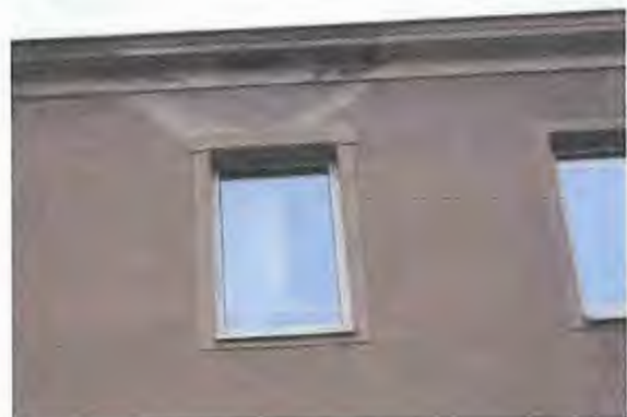
vermuteter Schwammbefall im Traufbereich
