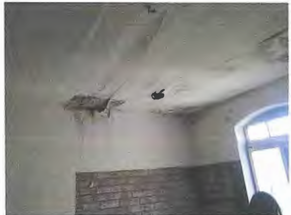
Nässeschäden in der Dachkonstruktion
