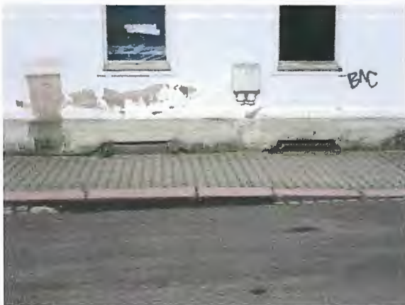
Feuchteschäden im Sockelbereich außen
