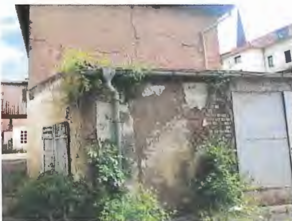
Gebäude 4, Südansicht, ruinöser Garagenanbau
