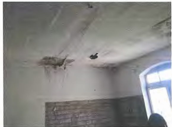
Feuchteschäden Decke über 2. Obergeschoß
